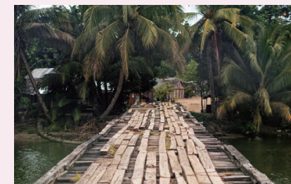
村をつなぐ小さな橋は地域社会に不可欠です。これらは頻繁に修復が必要になります。
